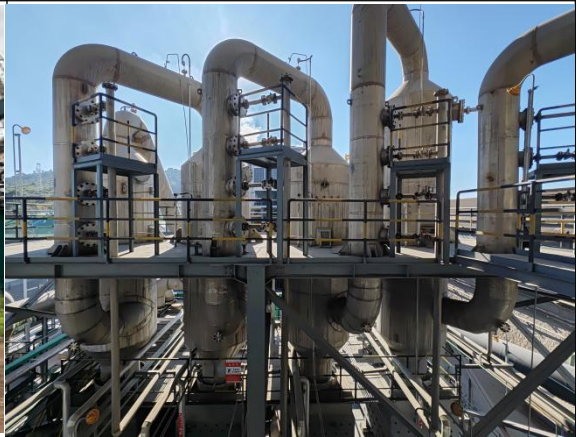
公司黄磷尾气气罐
