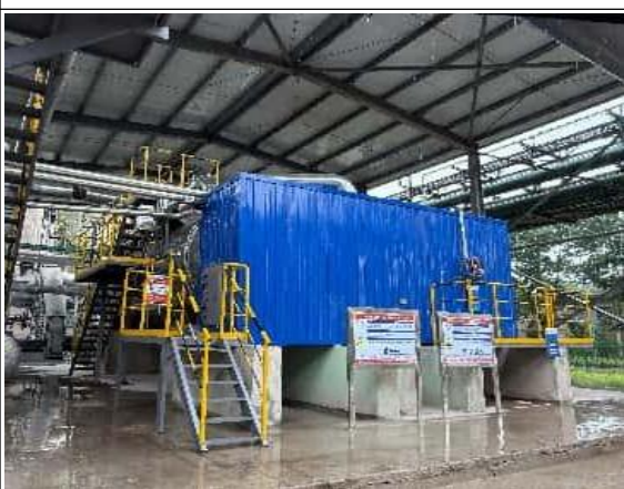
项目 2#锅炉现状照片
