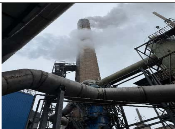
项目排气筒 DA007 现状照片
