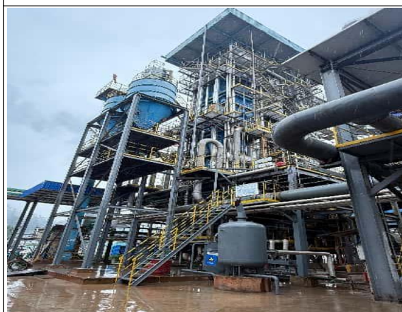
项目 1#锅炉现状照片
